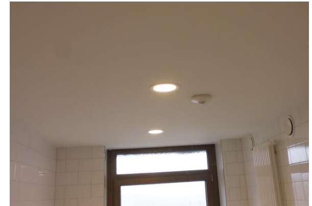
Neue LED- Beleuchtung im Nasszellenbereich
