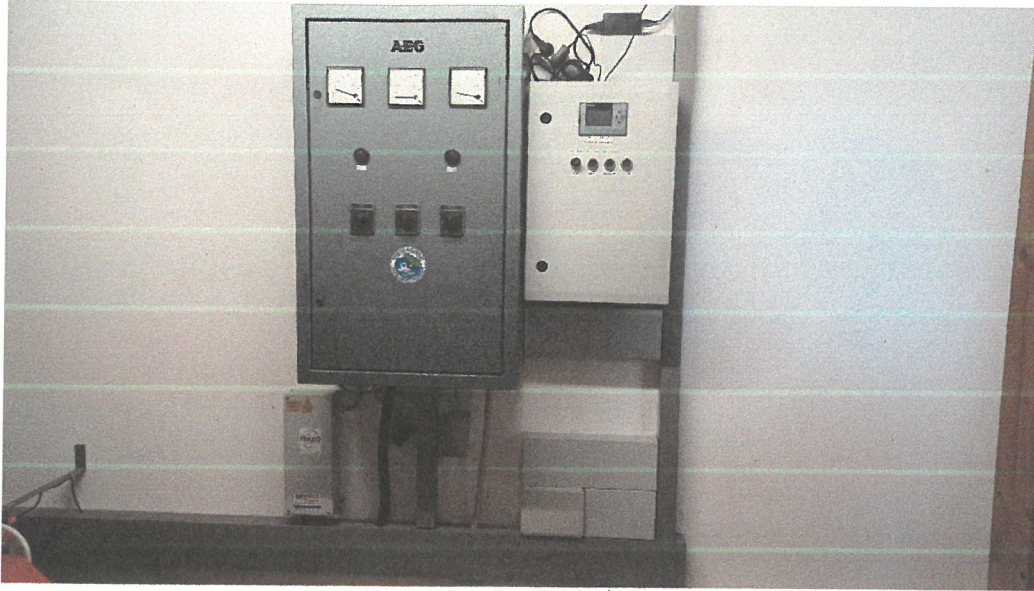
Schaltschrank und SPS
