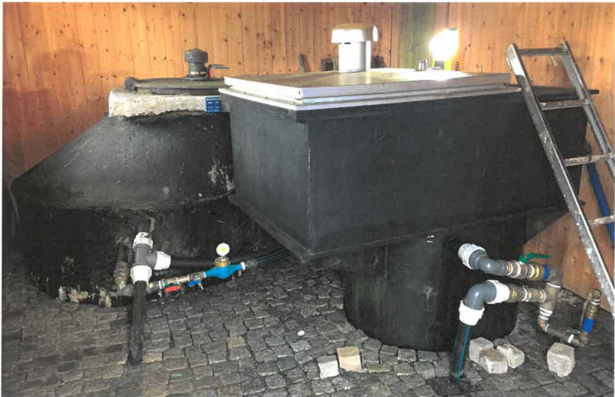
Abbildung 3: Aufbereitung (rechts) und Hochbehälter (links) der Flanitzquelle
