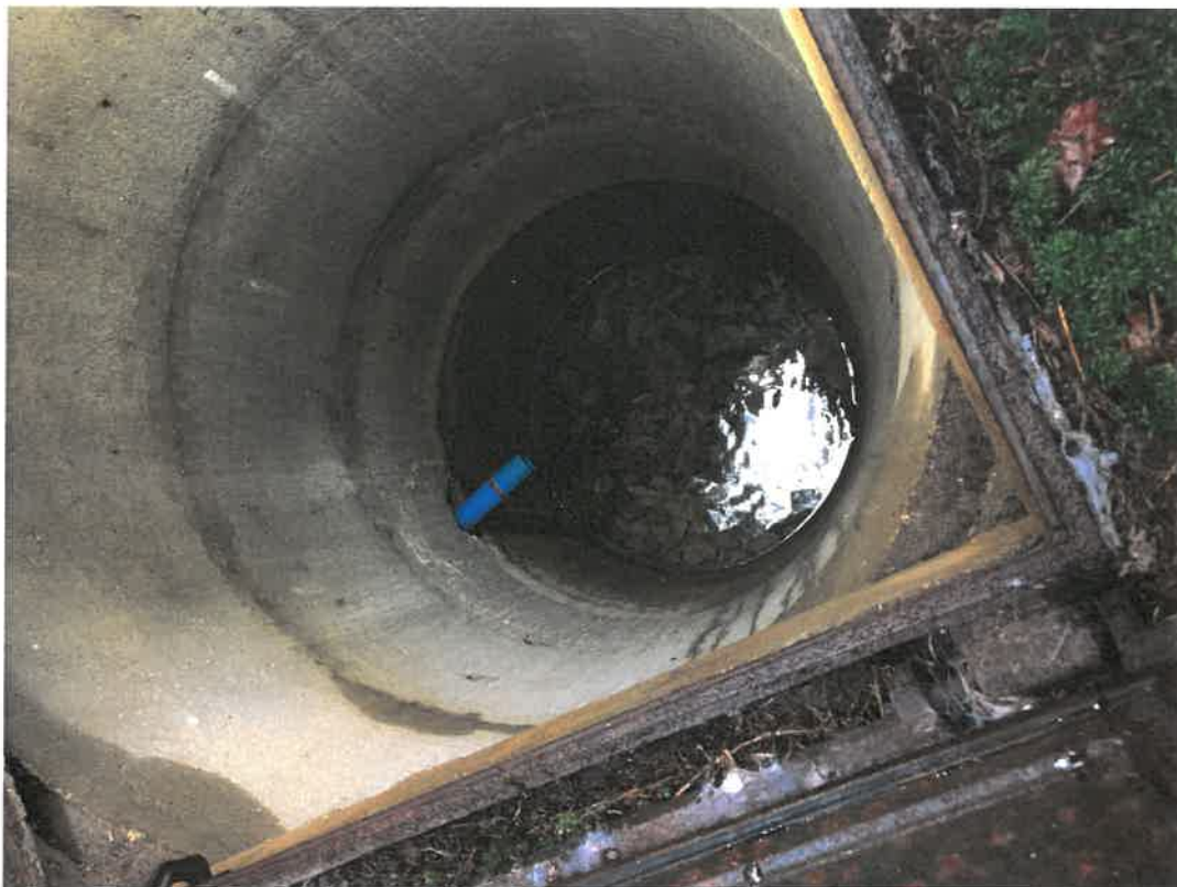
Abbildung 1: Blick in die Quellfassung bei geöffnetem Deckel
